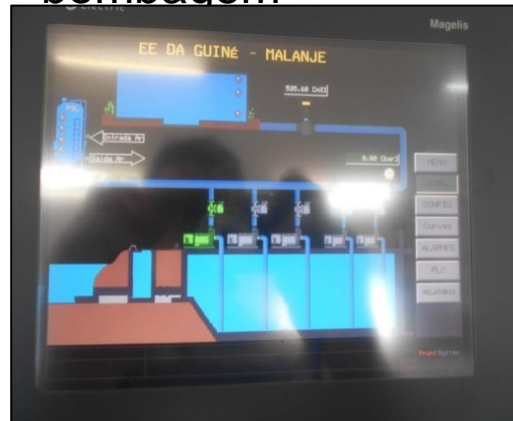
Fig 1 - Ecrã de controlo da estação de bombagem
