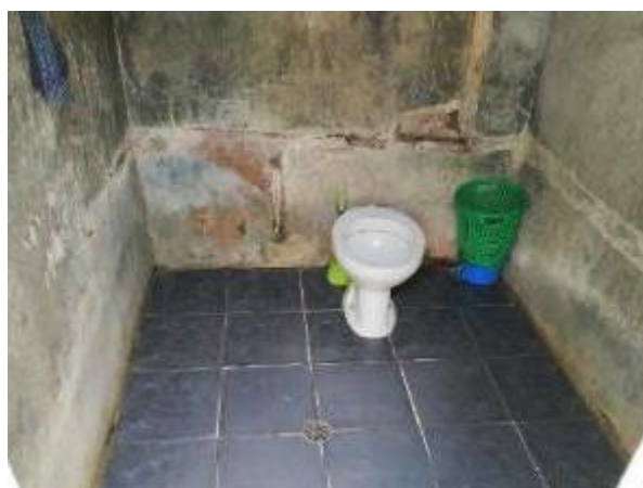
Figura 128 – Instalação sanitária sem equipamento para lavagem de mãos (bairro Camunda)
