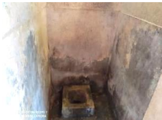
Figura 125 – Instalação sanitária sem equipamento para lavagem de mãos (bairro Calohombo)
