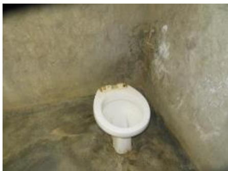
Figura 98 – Pormenor de instalações sanitárias na escola O Sagrado Pensador II (bairro 4 de Abril)
