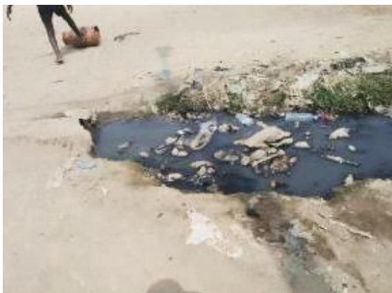
Figura 130 – Resíduos numa vala de drenagem (bairro Calundo)
