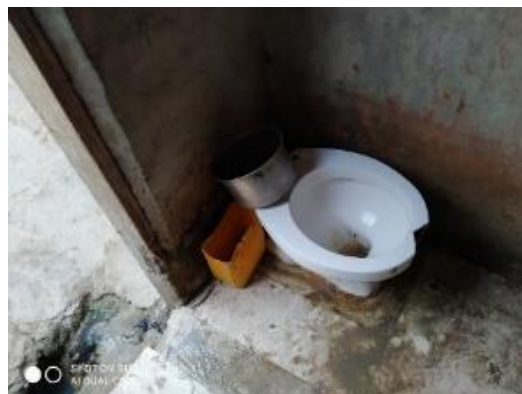
Figura 126 – Instalação sanitária sem equipamento para lavagem de mãos (bairro Dokota)
