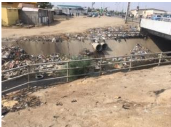
Figura 68 - Deposição de resíduos na Vala do Coringe
