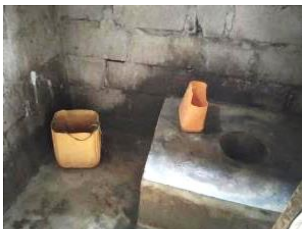
Figura 127 – Instalação sanitária sem equipamento para lavagem de mãos (bairro Casseque Macau)
