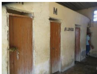
Figura 97 – Instalações sanitárias para os alunos da escola O Sagrado Pensador II (bairro 4 de Abril)
