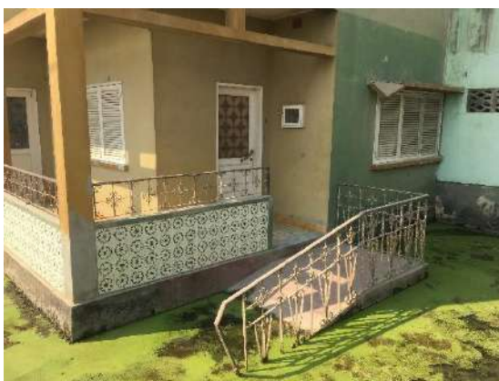
Vista geral de habitação em zona com nível freático muito elevado (vista 3, bairro de São João)
