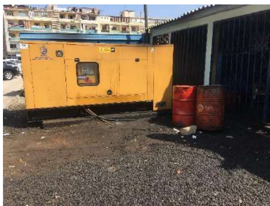
Grupo gerador junto à Estação Elevatória 1
