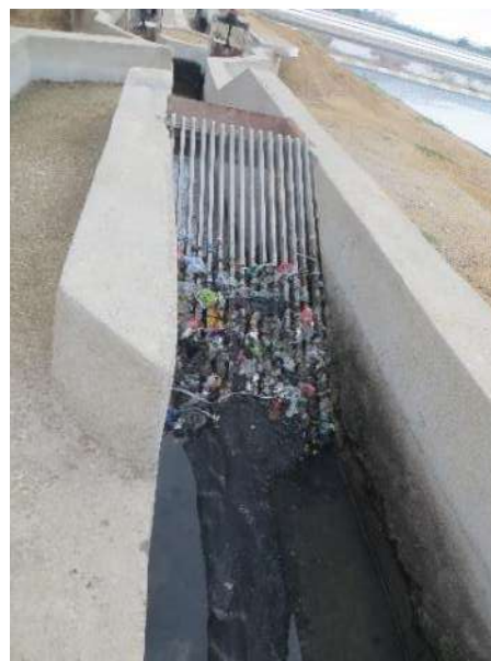
Obra-de-entrada da ETAR (canal de gradagem e by-pass à segunda grade)
