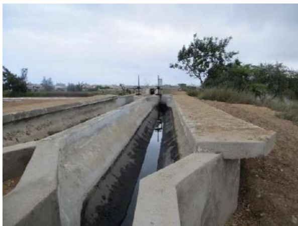
Obra-de-entrada da ETAR (vista geral dos desarenadores gravíticos)
