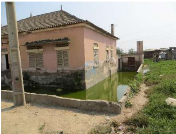
Vista geral de habitação em zona com nível freático muito elevado (vista 1, bairro de São João)
