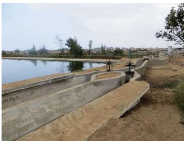
Obra-de-entrada da ETAR (vista geral)
