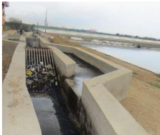
Obra-de-entrada da ETAR (canal de gradagem e by-pass à primeira grade)
