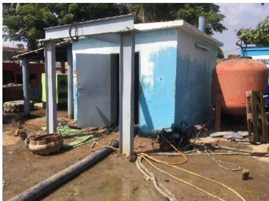
Visita à Estação Elevatória 2
