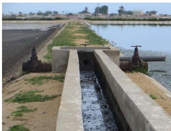
Pormenor da câmara de repartição de caudal às lagoas primárias
