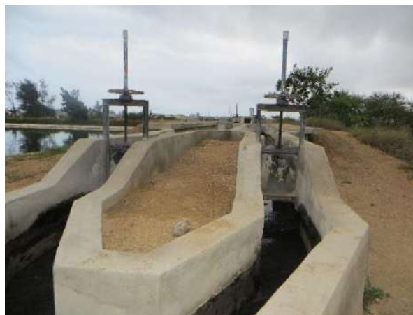
Obra-de-entrada da ETAR (vista a jusante dos desarenadores gravíticos)
