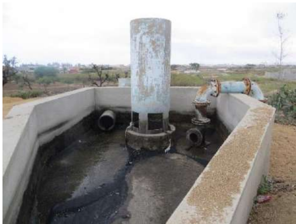
Obra-de-entrada da ETAR (câmara de recepção do caudal elevado)
