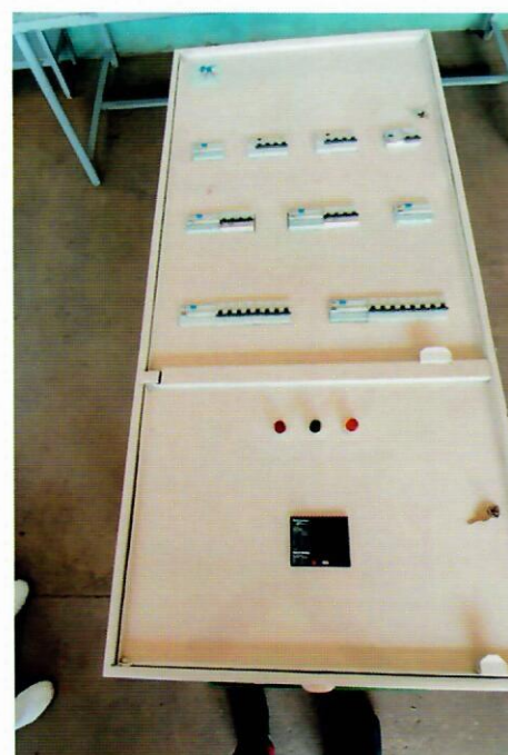
Quadro de AVAC
