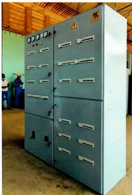
QGBT - Quadro Geral de Baixa Tensão
