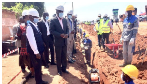
Instalação de novas ligações domiciliaries nas zonas periurbanas dos distritos do Dundo e Mussungue
