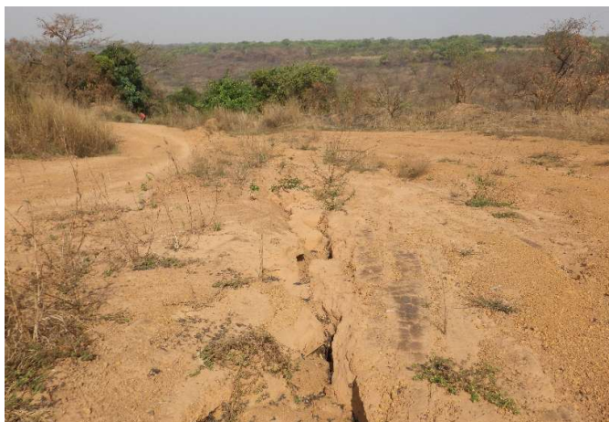
Figura 23 – Ravinas em solo arenoso
